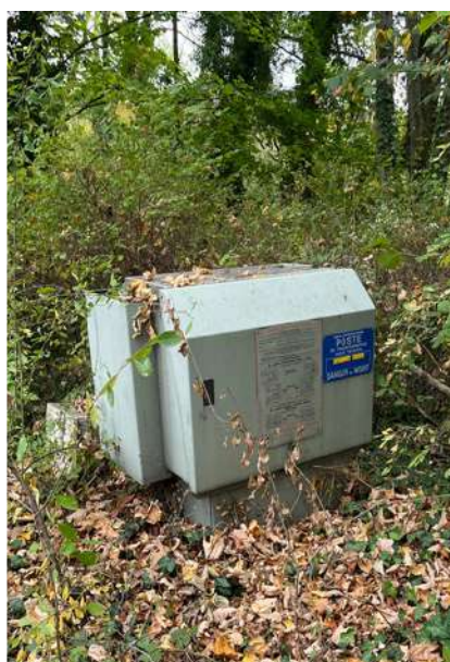
Poste préfabriqué au sol simplifié
